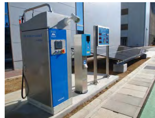
太陽光発電・急速充電システム
