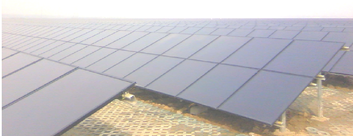
太陽光発電システム
