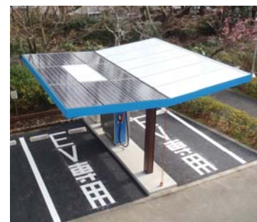
EV用急速充電システム
