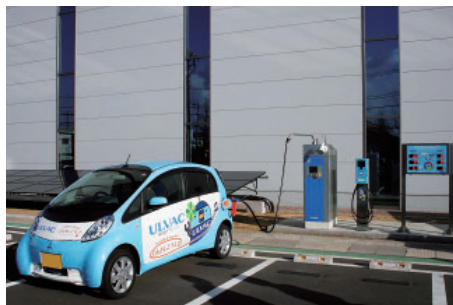
茅ヶ崎本社工場に設置された電気自動車とEV充電設備
