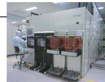
イオン注入装置
