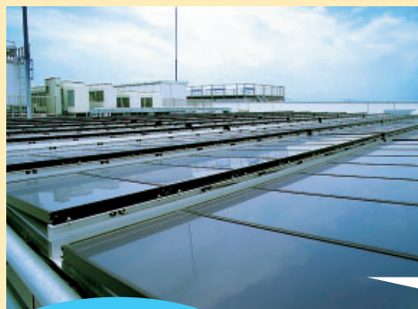
茅ヶ崎工場屋上の太陽電池
