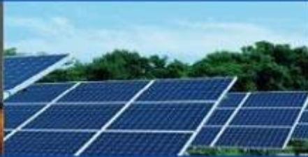
Photovoltaic 太陽電池
