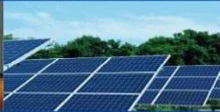
Photovoltaic 太陽電池
