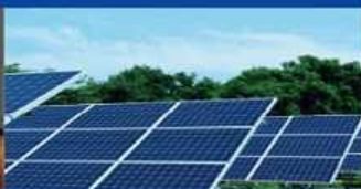
Photovoltaic 太陽電池
