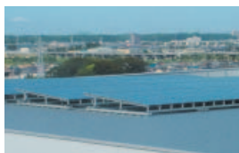
アルバック茅ヶ崎工場の屋上に設置された太陽電池パネル
