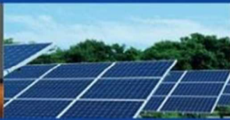
Photovoltaic 太陽電池
